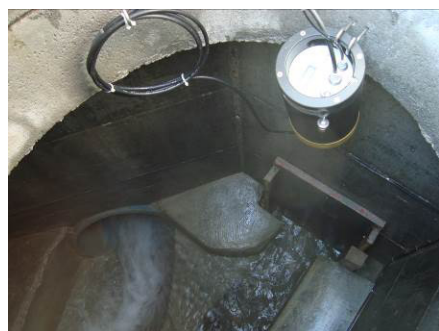
Débitmètre installé dans le collecteur
