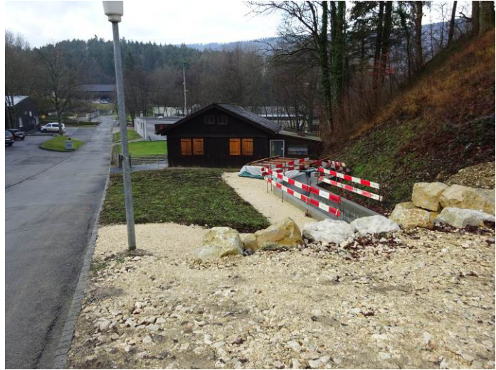
Unterirdische Turbinenzentrale (Stand vor der Montage des Dachs über der Maschinengruppe und dem Gebäudezugang)
