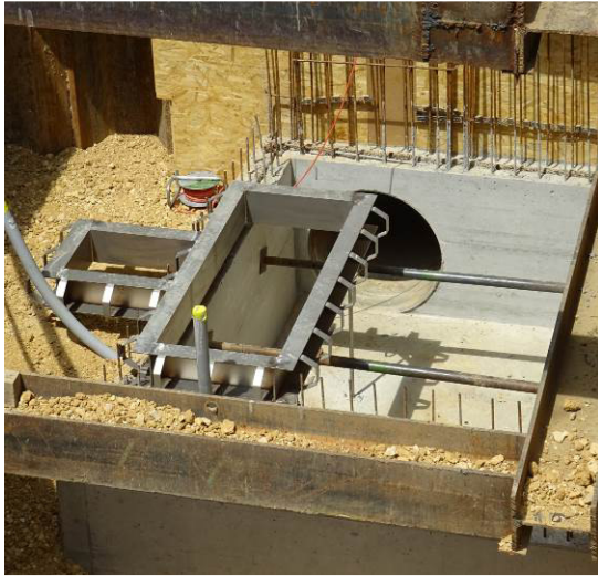
Grube unterhalb der Turbine/Einlass, die zur Entlastungsleitung führt
