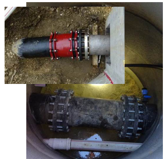
Mechanische Muffe (Waga) / Ausbaurohr im Schacht
