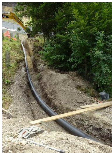
Sanfte Kurven der Rohrleitung
