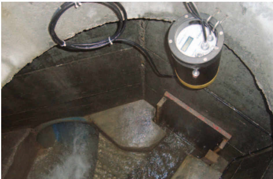
Abb. 1: Im Schacht montiertes Durchflussmessgerät, oben rechts die Einheit der Datenerfassung und Speicherung
